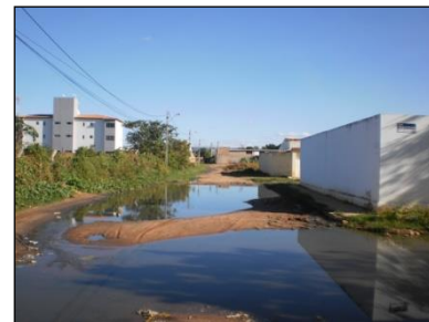
Figura 1 – Acúmulo de Efluentes na Rua Raimundo Vicente de Lima, Tiradentes.
